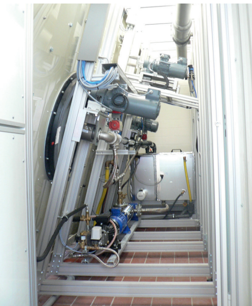
Voorbeeld: technische onderhoudsvriendelijke ruimte achter in de installatie SPZ-K Classic Line en Basic Line
