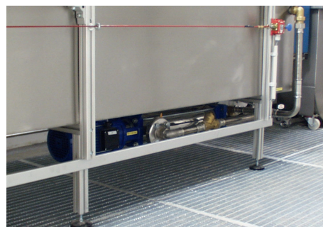
(roestvrijstalen testpomp zonder vloer onder het pompput)
