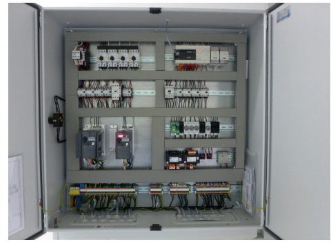
Schakelkast met onderhoudsvrije SPS-besturing
